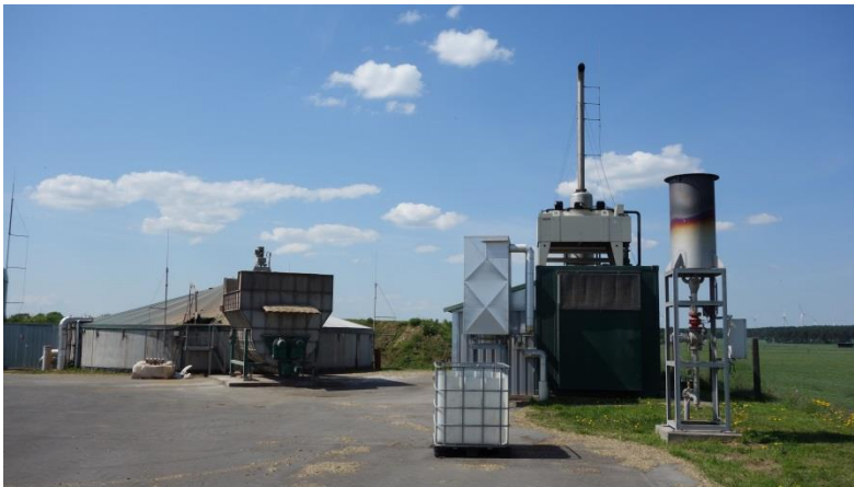
BHKW mit Leitzentrale (PLS mit SPS) und Notfackel
