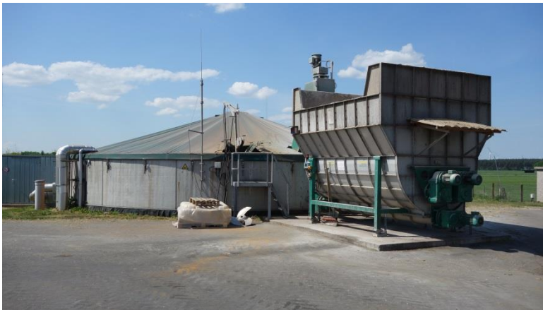
Annahmedosierungssystem , Anmisch- und Hydrolysesystem
