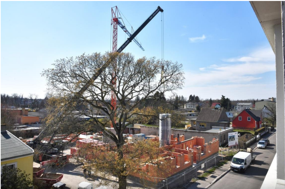
Abbildung 2 Bei bestem Wetter wurden die Wärmespeicher für die energieautarken Mehrfamilienhäuser in Oranienburg aufgestellt. Foto Enrico Kugler/ Wohnungsbaugesellschaft mbH Oranienburg (WOBA)
