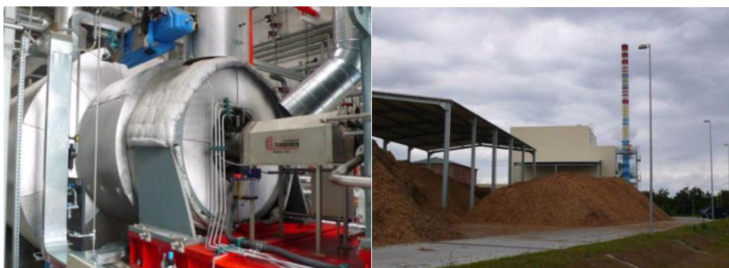
Foto: Kraft-Wärme-Kopplung durch ORC-Anlage mit Turbine Foto: Hackschnitzellager
