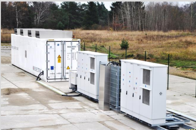
(Abbildungen, BELECTRIC: Solarkraftwerk, BatteriegröÙspeichereinheit)
